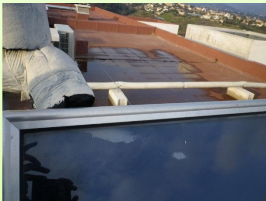
Décoloration des couvertures des capteurs solaires.
